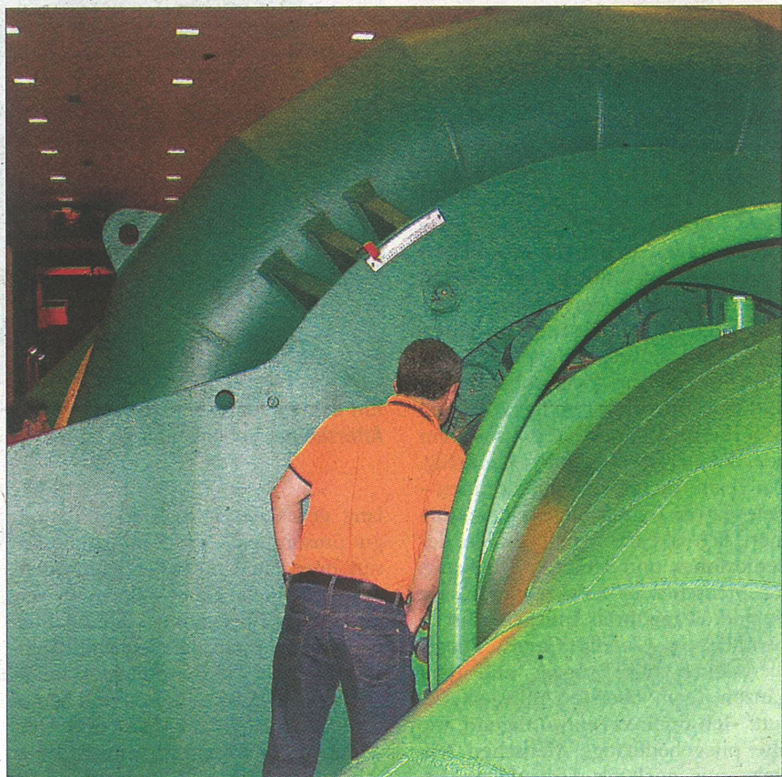
Faszinierende Technik: Gigantische Apparaturen im Grimselkraftwerk
